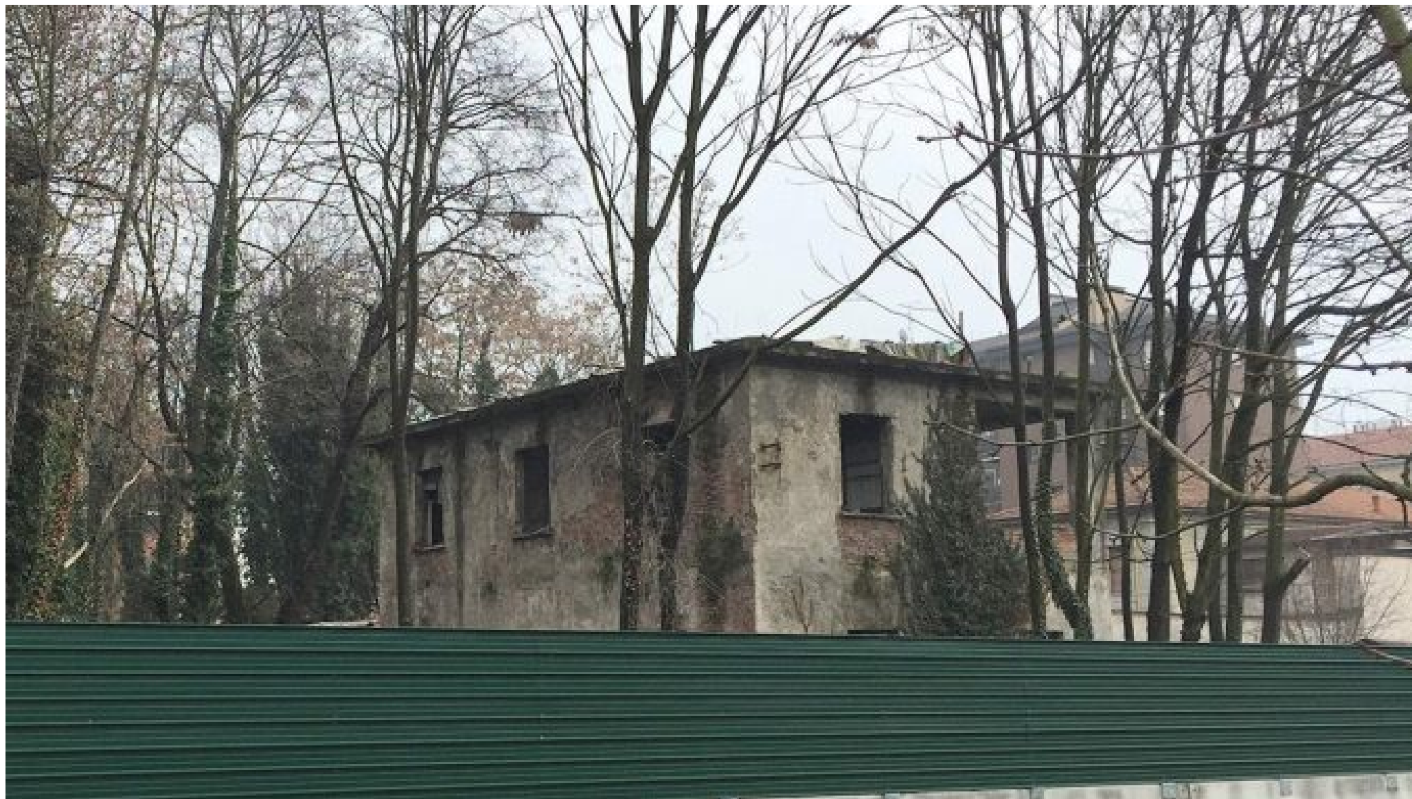
L'area abbandonata da oltre 20 anni, presto partiranno le demolizioni delle ex porcilaie della storica villa in zona Quarto Oggiaro (Foto Facebook Fabio Galesi)
